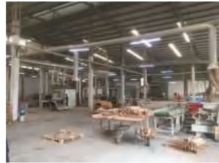
Hệ thống hút bụi hiện đại
